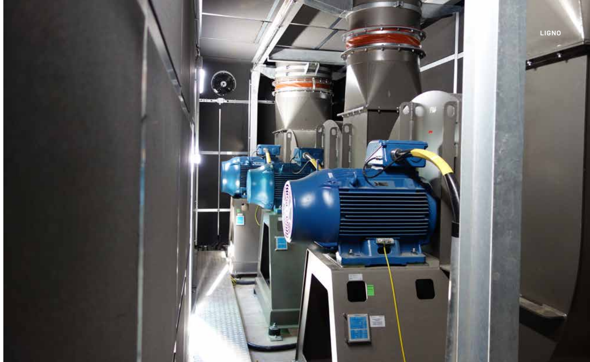
Die Derix-Gruppe setzt bei ihrem Werk in Westerkappel, Deutschland, auf Lüftungsanlagen der Scheuch LIGNO.
