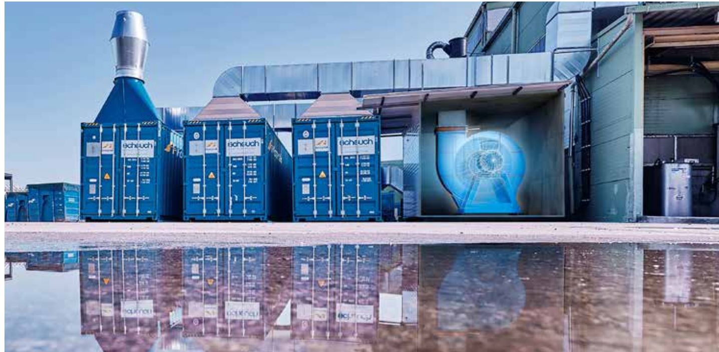
Geruchsfilter OEC bei der FCC Austria Abfall Service AG
